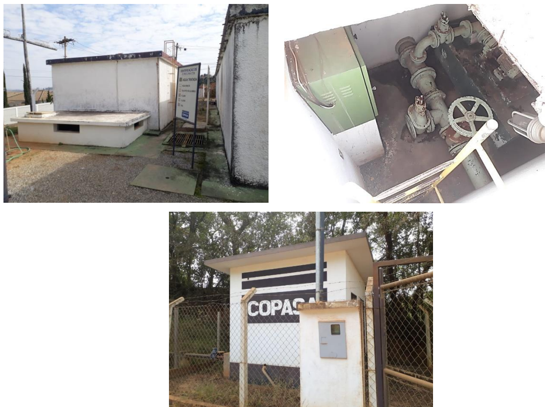
Figura 3.7 - Estação elevatória situada na ETA e booster.
