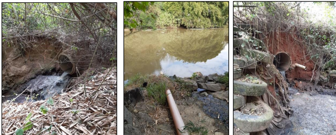
Figura 5.3: Pontos de lançamento de esgoto na zona urbana.
