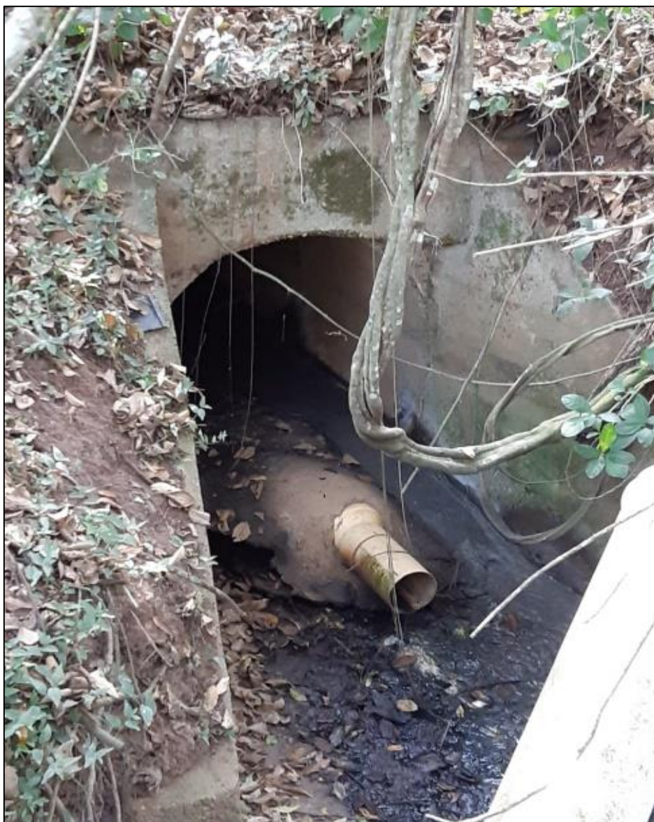
Figura 5.6: lançamento de esgoto sanitário junto a drenagem pluvial.
