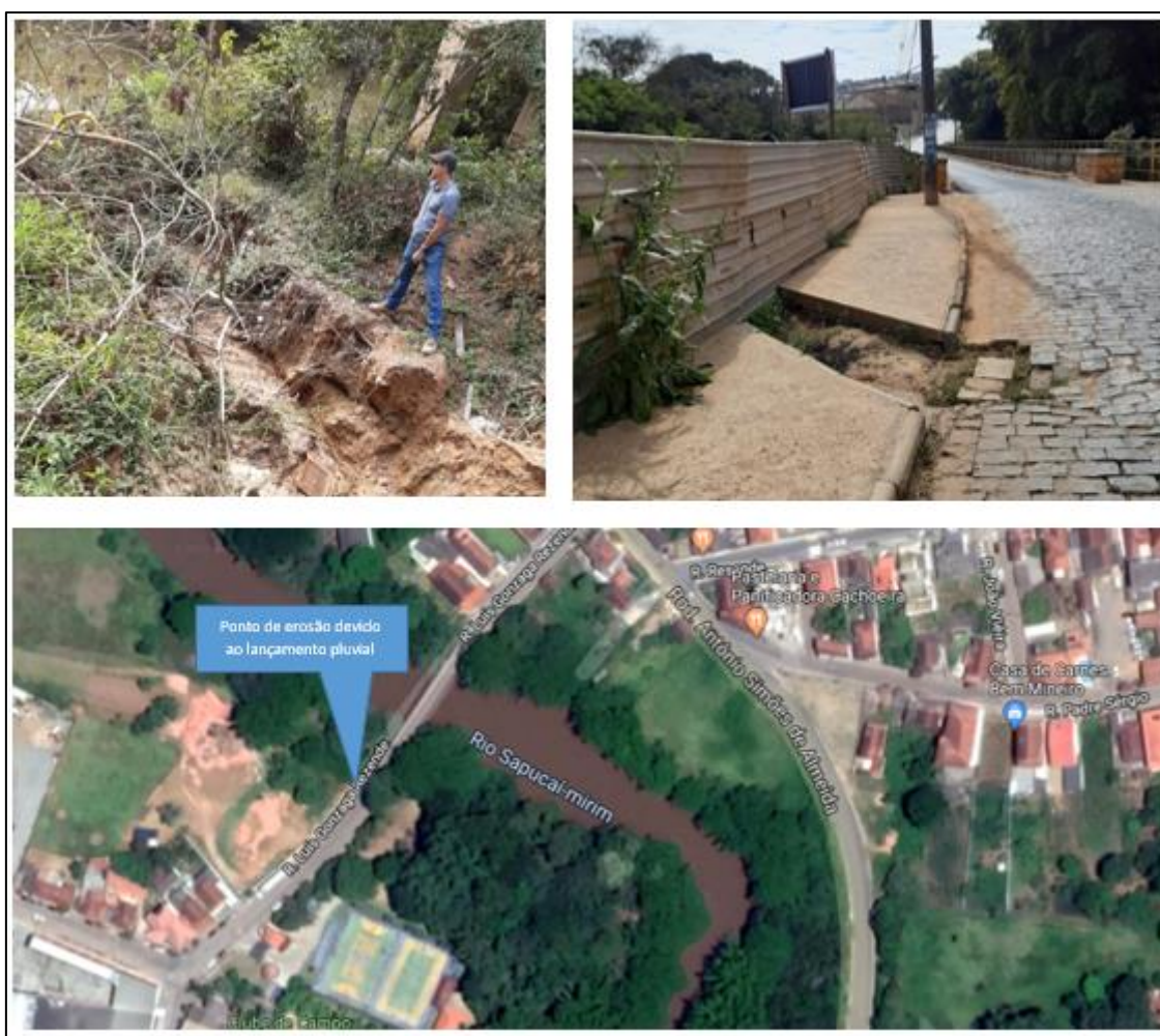
Figura 4.7 - Lançamento não estruturado de águas pluviais e processo erosivo decorrente do lançamento.
