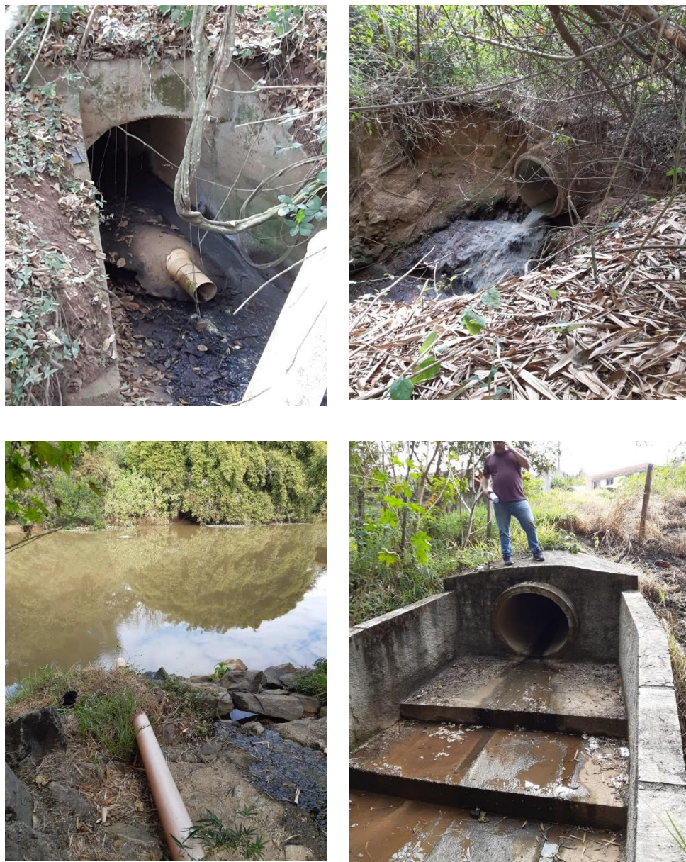
Figura 4.6 – Fotos dos pontos onde se observa lançamento de esgoto junto a drenagem ou com tubulações próprias.
