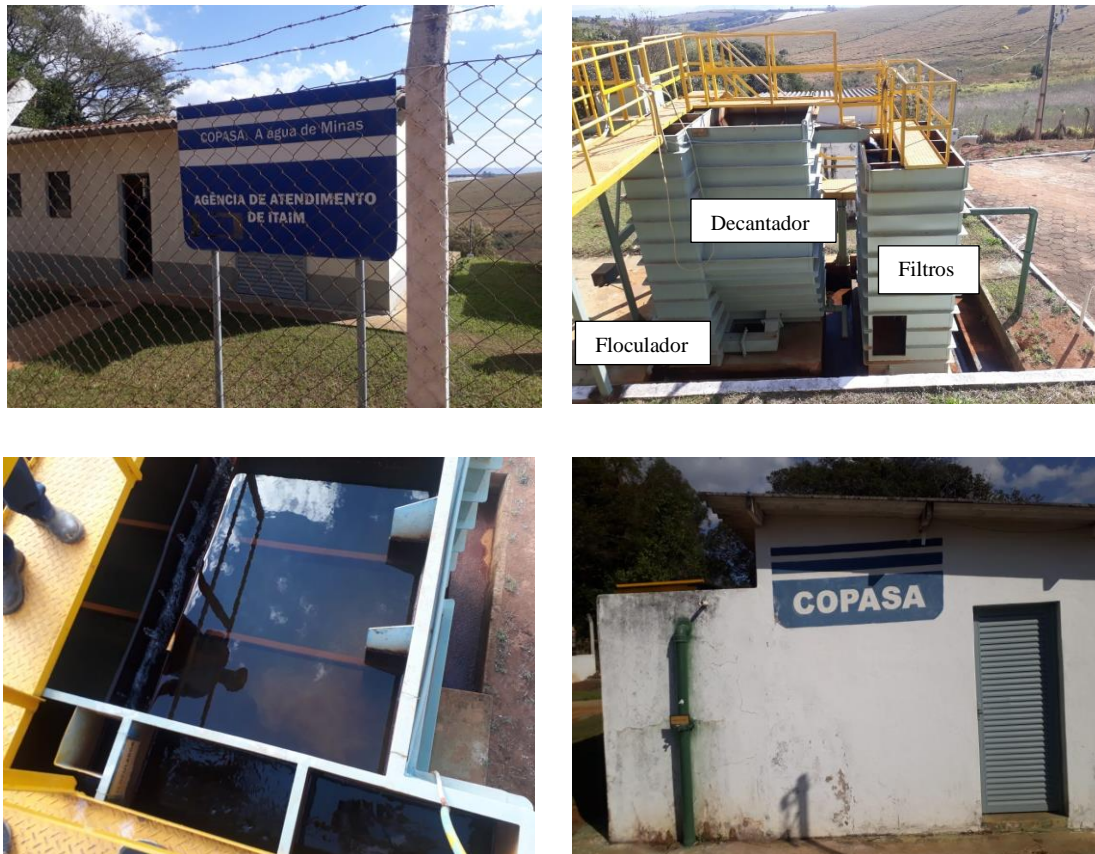
Figura 3.18 - Estação de Tratamento de Água de Itaim.
